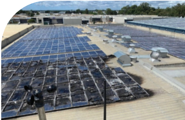
Slika 12: Oštećen fotonaponski panel
