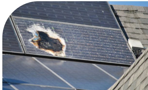
Slika 13: Oštećen fotonaponski panel
