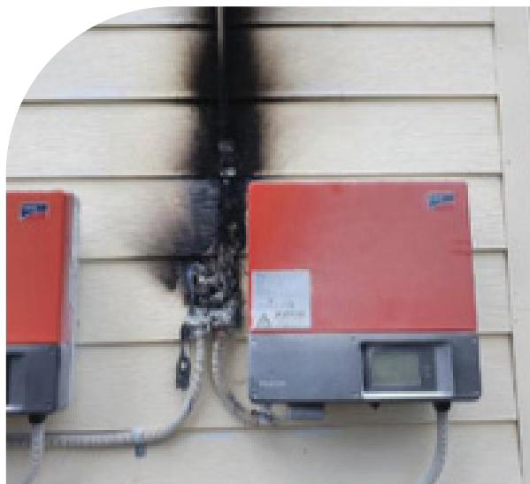
Slika 15: Oštećen inverter usled pregrevanja
